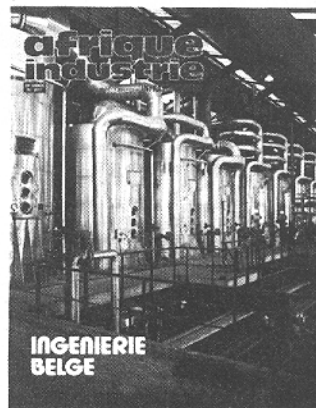
Usine de Ouélé au Gabon. Capacité : 2 850 t de cannes par jour, vue des évaporateurs. (Réalisation ABR).
