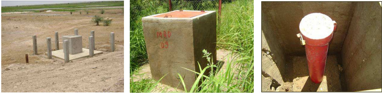
Photo 39, 40, 41 : Vues clôture, dalle et abri piézomètre (RIM), abri en béton avec couvercle (Mali) et tête de piézo avec couvercle (Mali)
