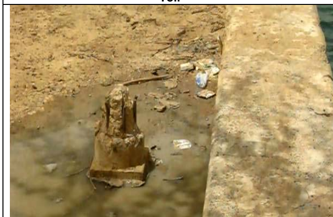
Figure 20: Bitte d'amarrage détruite au niveau de l'escale Richard Toll
