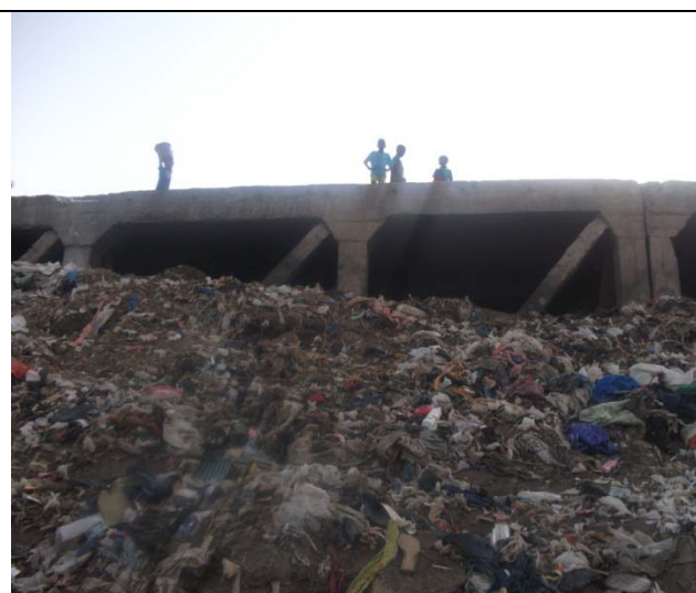
Figure 60 : Bas du Quai où les détritits s'entassent (plusieurs centaines de tonnes de déchets à nettoyer)
