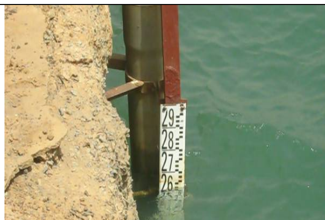
Figure 21: Poutre de couronnement et échelle limnimétrique au niveau de l'escale Richard Toll
