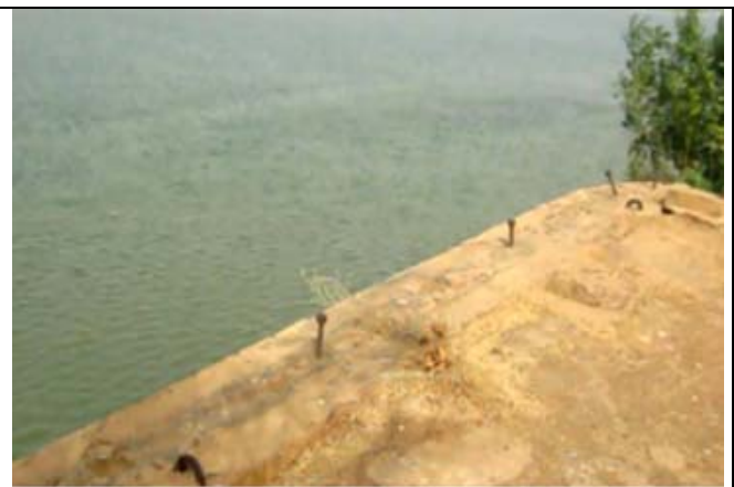
Figure 48: Tiges d'acier pour accostage au niveau du quai
