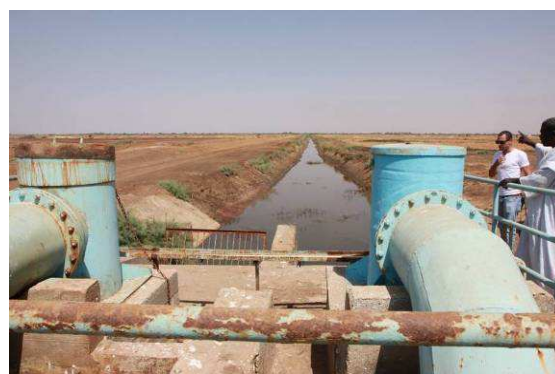
Figure 20 : Station de pompage (Béléré)
