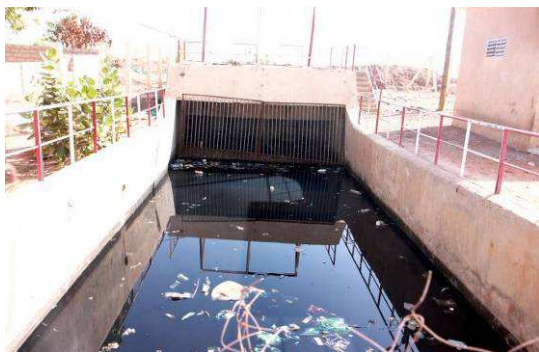
Figure 2 : Dégrillage des eaux pluviales de Rosso
