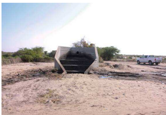
Figure 25 : Vue de l'arrivée des eaux usées brutes à la station de lagunage de Saint – Louis.
