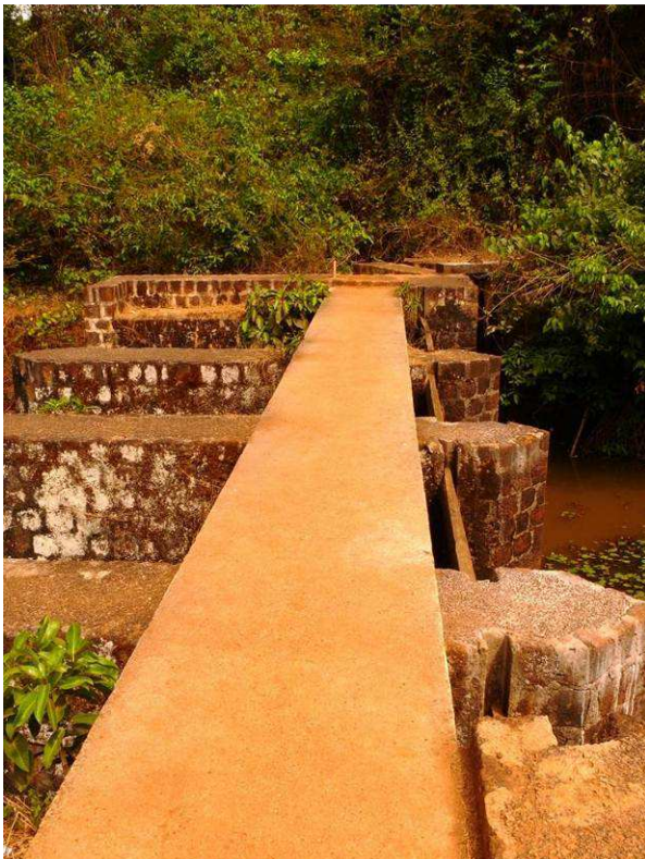
Figure 19 : barrage de Tolo ouvrage abandonné
