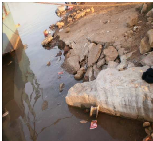
Photo 14 : Etat de dégradation du quai de Bafoulabé sur la rive droite
