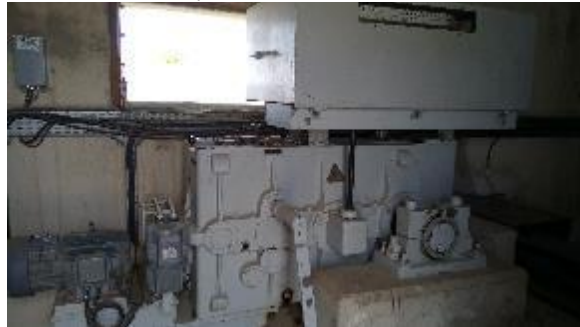
Détail d'un organe de manœuvre d'une vanne (motoréducteur et son moteur d'entraînement)
