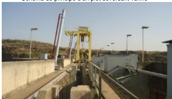
Détail du pont roulant permettant la manipulation des différents batardeaux
