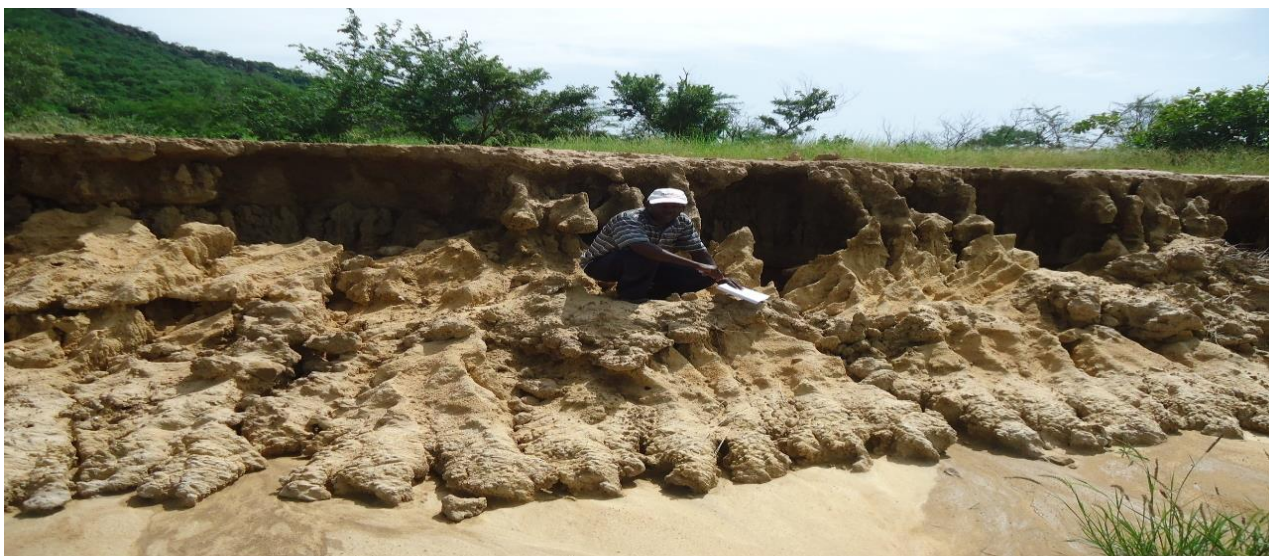
Figure 34 : Menace de l'érosion sur l'axe routier Djoubeba-Solinta à proximité de la rivière Bakoye commune de Oualia, cercle de Bafoulabé
