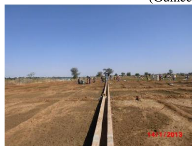
PIV réhabilité à Bafoulabé (Mali)
