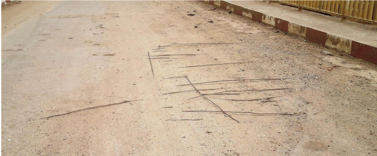
Armatures apparentes sur la chape de roulement du pont.
