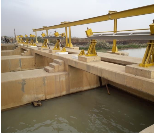
Vue des ensembles de manœuvre des 4 vannes
