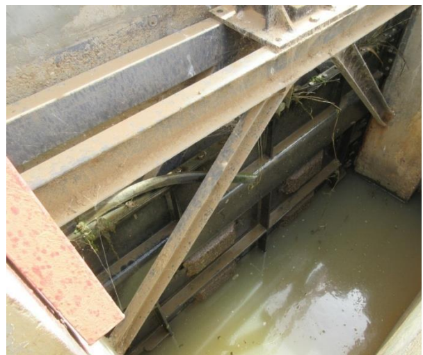
Joint d'étanchéité déchiré. On distingue les anodes sacrificielles
