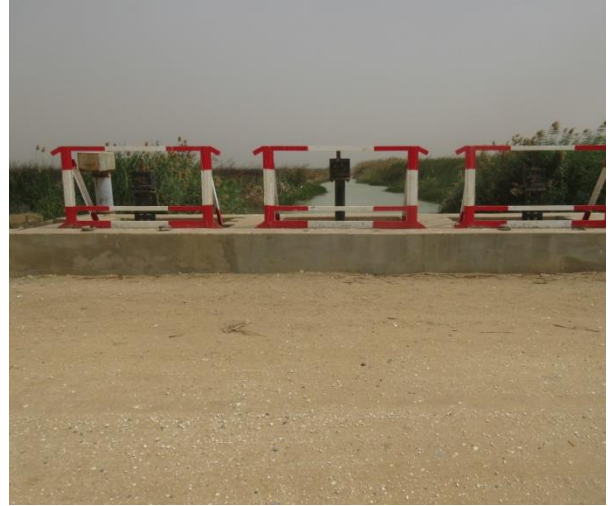
Vue des 3 dispositifs de manœuvre des vannes
