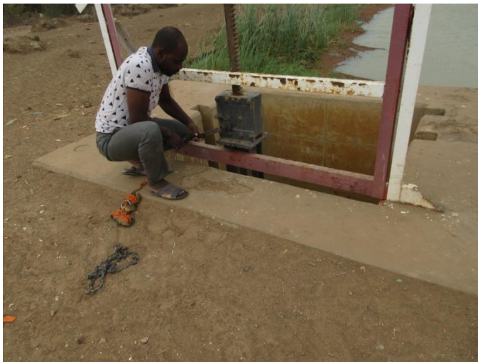
La position du cric est trop basse. La manivelle touche le béton
