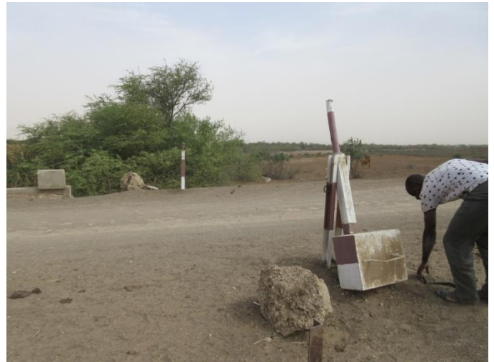
Barière de pluie hors d'usage.
