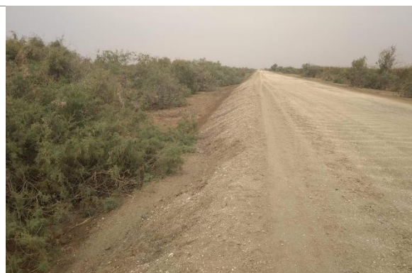
Sapement du pied de talus au droit d'un marigot
