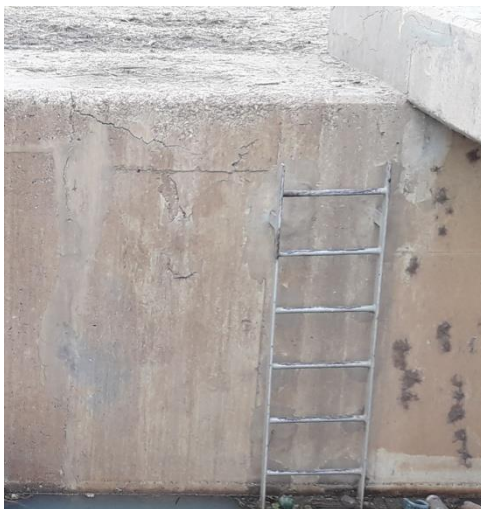
Fissures au sommet du voile de la culée RD
