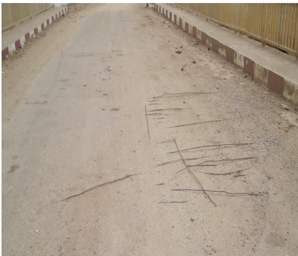
Dalle du pont : armatures apparentes et sans aucun enrobage
