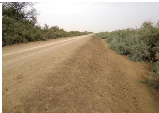
Erosion du talus liée au piétinement par le bétail
