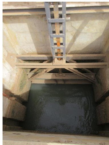
Vue de la potence, de la crémaillère, du plat métallique rouillé et de la poutre frontale
