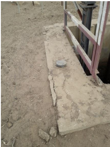
Arête supérieure de la chambre de vannes éclatée
