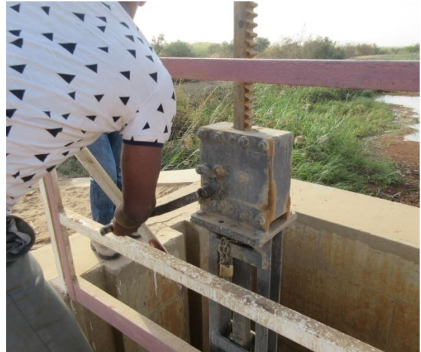
La manivelle frotte contre la lisse du garde-corps, occasionnant des blessures à la main.
