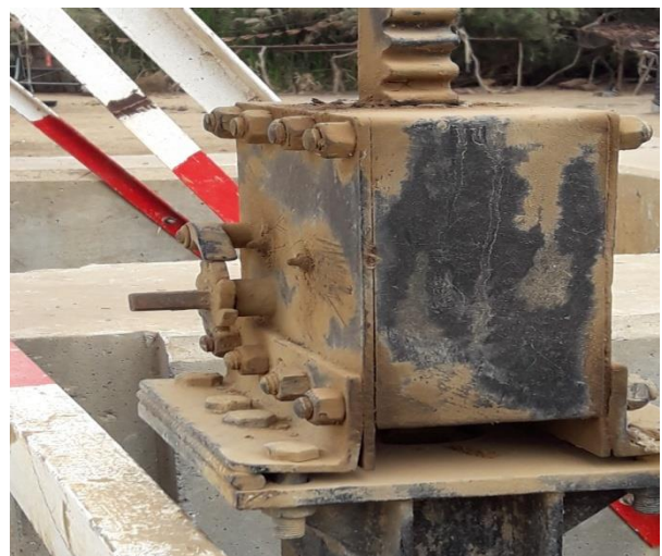
Calage du cric à manivelle sur la potence à l'aide de fers à béton.
