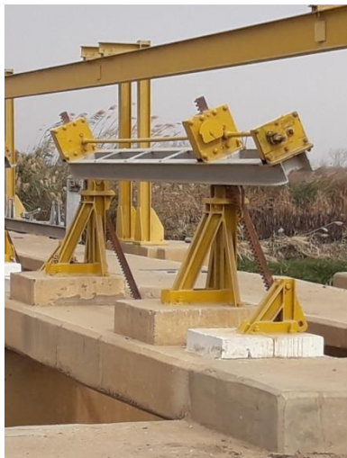
Ensemble de manœuvre des vannes murales : double réducteur à manivelle et boîtier de manœuvre latéral Louis Feugier Type 1D
