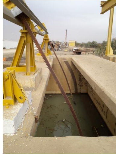
Ensemble de manœuvre de la vanne segment
