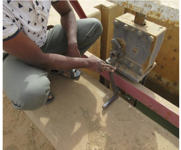
La vanne est très difficilement manœuvrable. La manivelle est bloquée par le béton !
