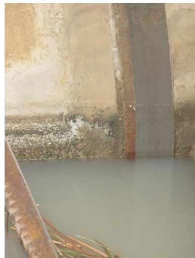
Vannes à segment : béton immergé délavé et guide oxydé
