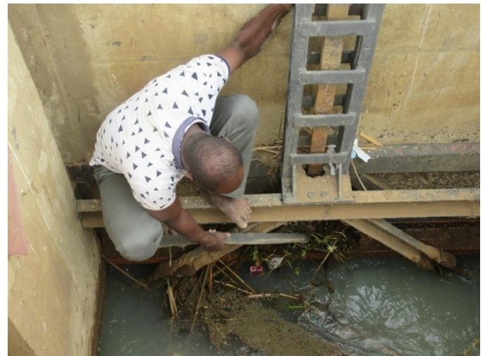
Les typhas et débris gênent le bon fonctionnement de la vanne
