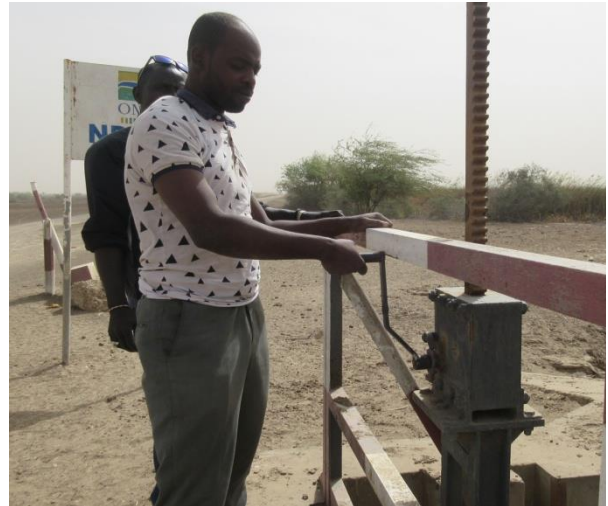
La manivelle touche la lisse supérieure du garde-corps
