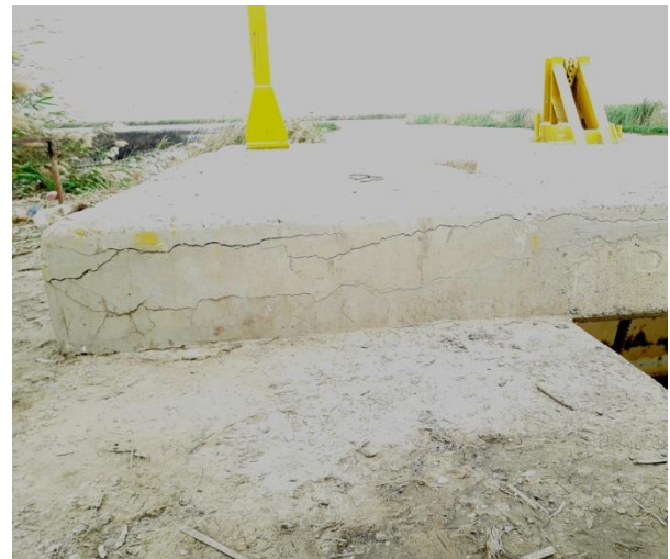
Fissuration des plots de soutien des vannes
