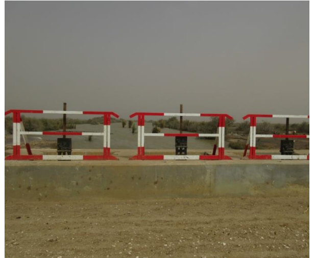
Les 3 vannes à simple réducteur à manivelle Louis Feugier type 0D
