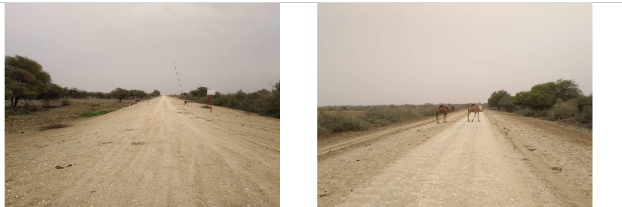
Digue de Bell: Un remblai d'une largeur de 3 à 4m avec des talus à pente douce (inférieure à 3H/1V)
