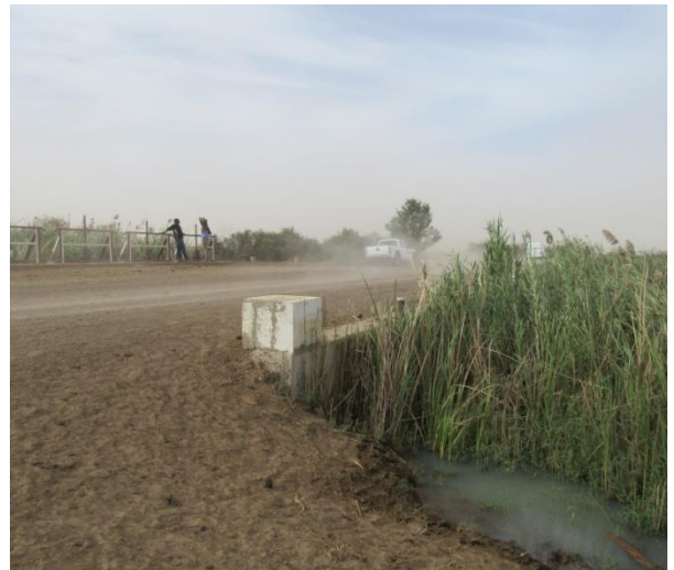
Vue de l'ouvrage depuis l'aval. L'écoulement est grandement obstrué par les typhas.
