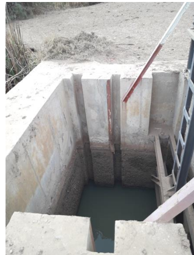
Le béton de la partie basse de la chambre de vanne est délavé
