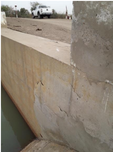
Décollement du ragrage du voile aval (côté Diama)
