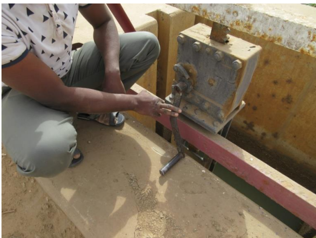
La vanne est très difficilement manœuvrable. La manivelle est bloquée par le béton
