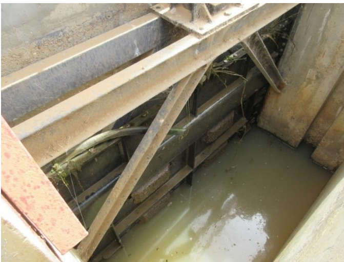
Joint d'étanchéité frontal déchiré. On peut distinguer les anodes sacrificielles
