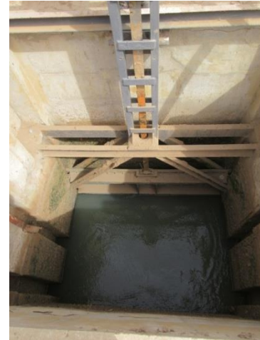
Vue de la potence, de la crémaillère, du plat métallique rouillé et de la poutre frontale
