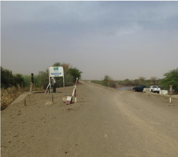
Vue de l'ouvrage en venant de Rosso. On remarque que la barrière de pluie est détruite
