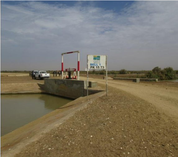
Vue de l'ouvrage en venant de Diama, depuis « l'aval ». On observe les ragréages sur le mur
