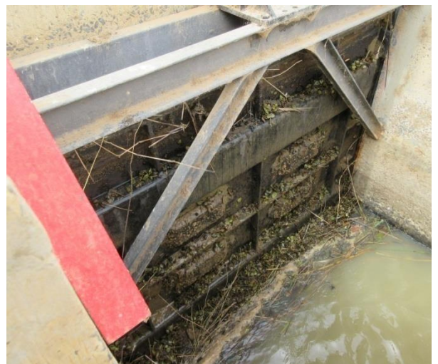
Vanne levée. On distingue les anodes sacrificielles mises en place sur la pelle
