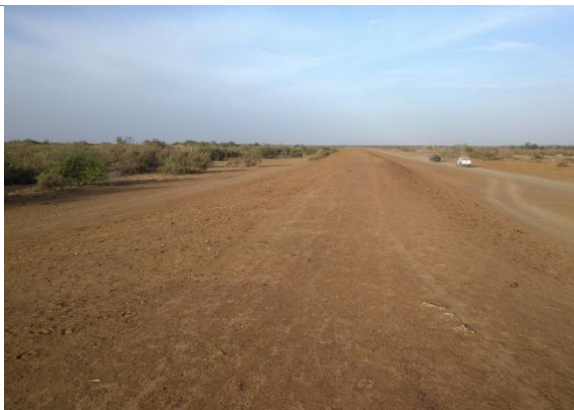
Réduction du gabarit de la digue du fait de son exposition et de l'absence de végétation en pied
