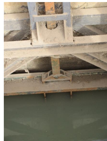
Plat de liaison corrodé. Axe d'arrêt en bon état
