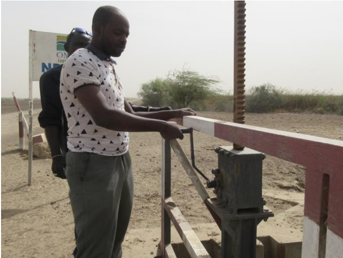
La manivelle touche la lisse supérieure du garde-corps
