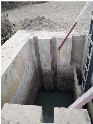
Le béton immergé de la chambre de vanne est délavé
