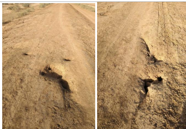
Secteur de fontis au droit du Pk85
