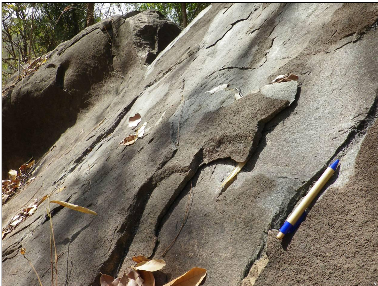
Figure A2. 26 - Bloc de dolérite en état d'altération superficielle – Rive gauche (altération en blocs ronds et en pelures d'oignons)
