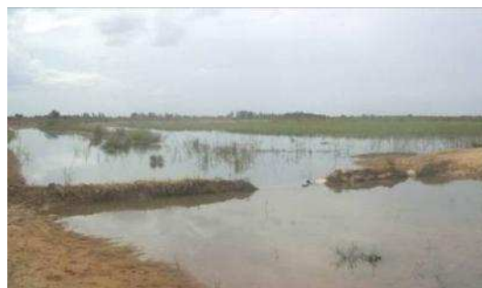
Photo 20 : digue détruite à Podor par les inondations prise en novembre 2009
