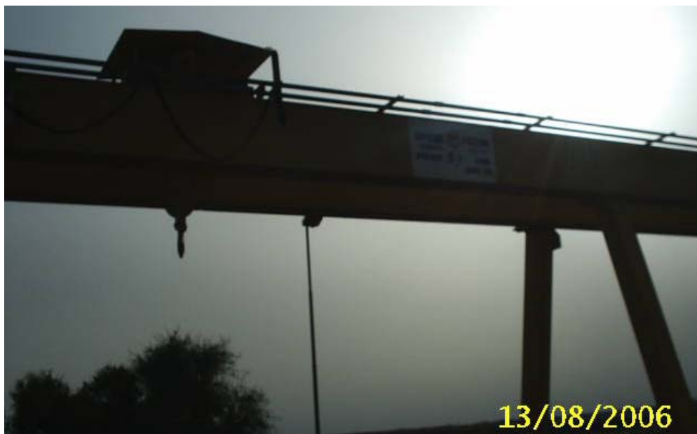
Vue du pont roulant
