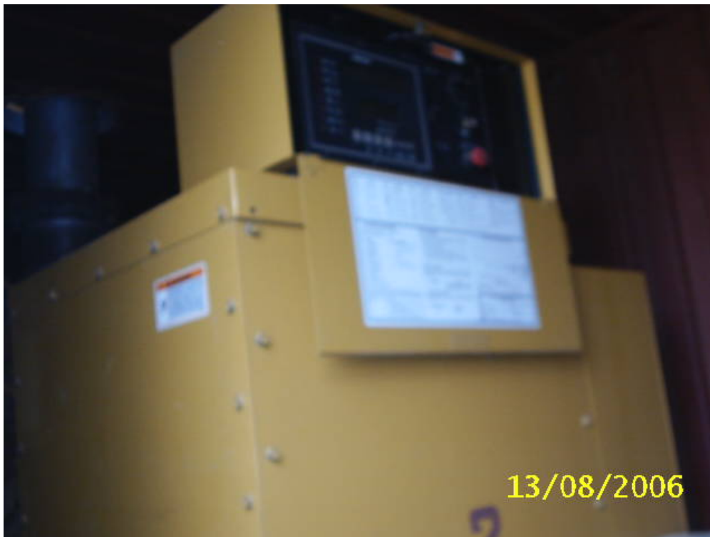
Vue avant du groupe électrogène en panne
