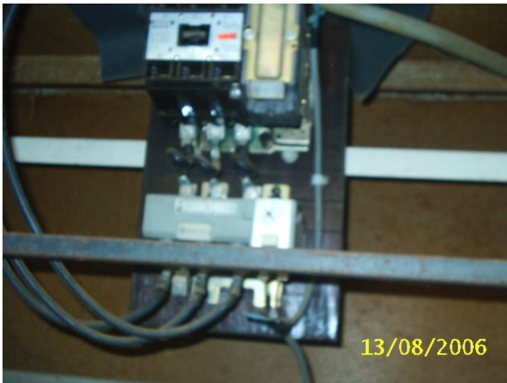
Technologies obsolètes du matériel électrique interne à l'armoire des électropompes
