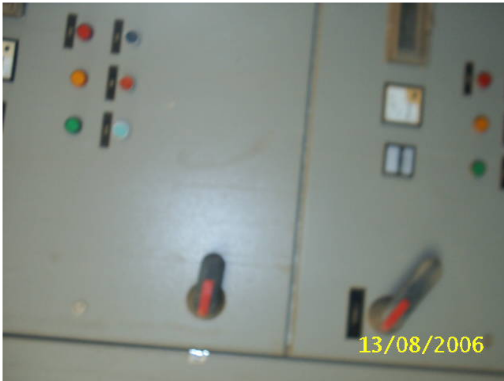
Face avant de l'armoire des électropompes
