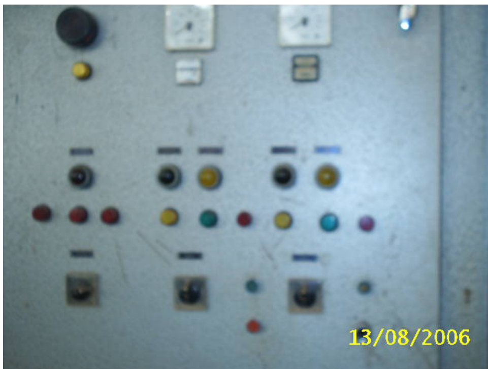
Face avant de l'armoire de PPG1 1
