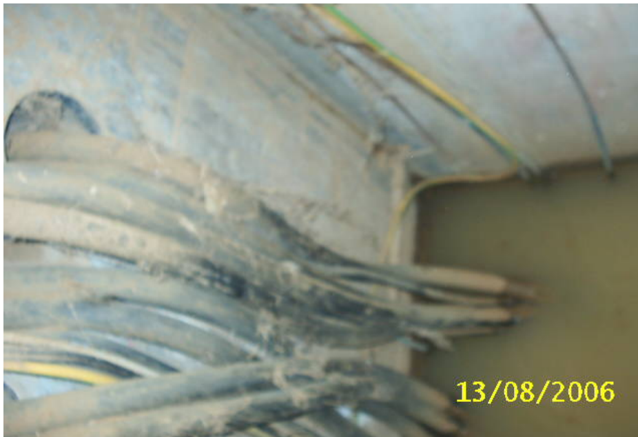
Vue des câbles à l'intérieur du regard externe (câbles noyés dans l'eau)
