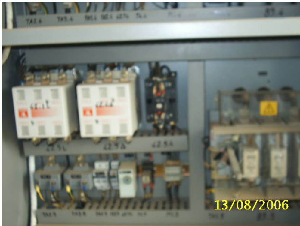
Module complet de commande d'une cellule
