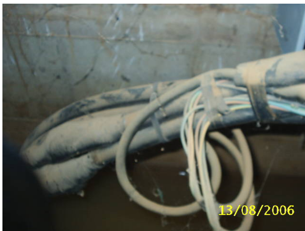
Vue inférieure l'armoire (câbles noyés dans l'eau)
