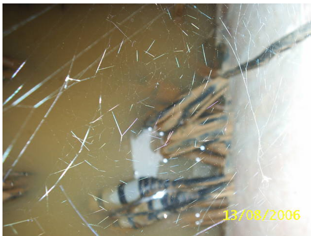
Vue d'une boîte à l'intérieur du regard externe (câbles noyés dans l'eau)
