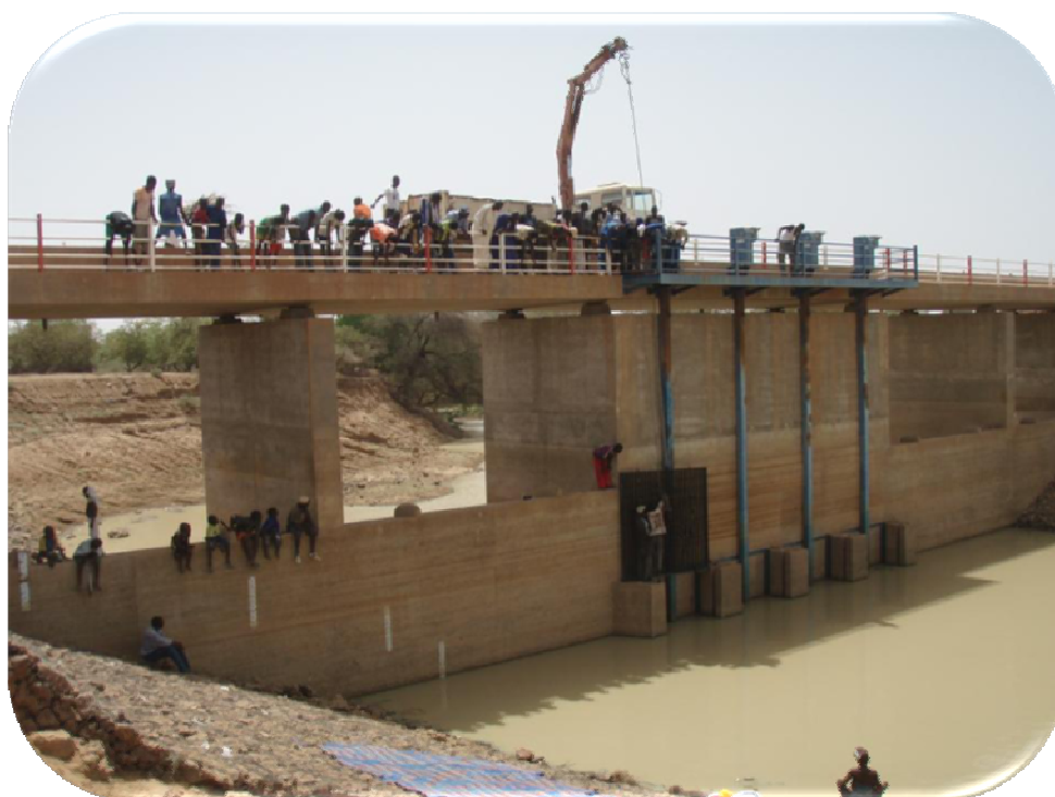
Ouvrage hydro agricole aménagé sur le Navel (Photo : CRSL)
