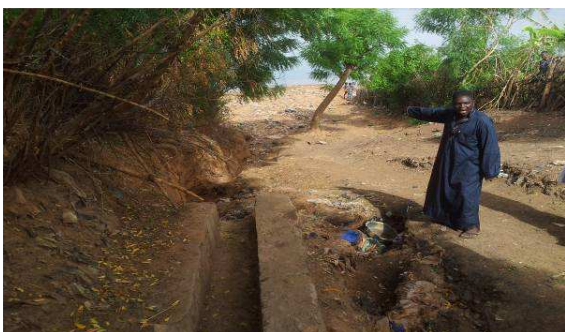
Evacuation eaux usées du marché de Mahina (Mali)
