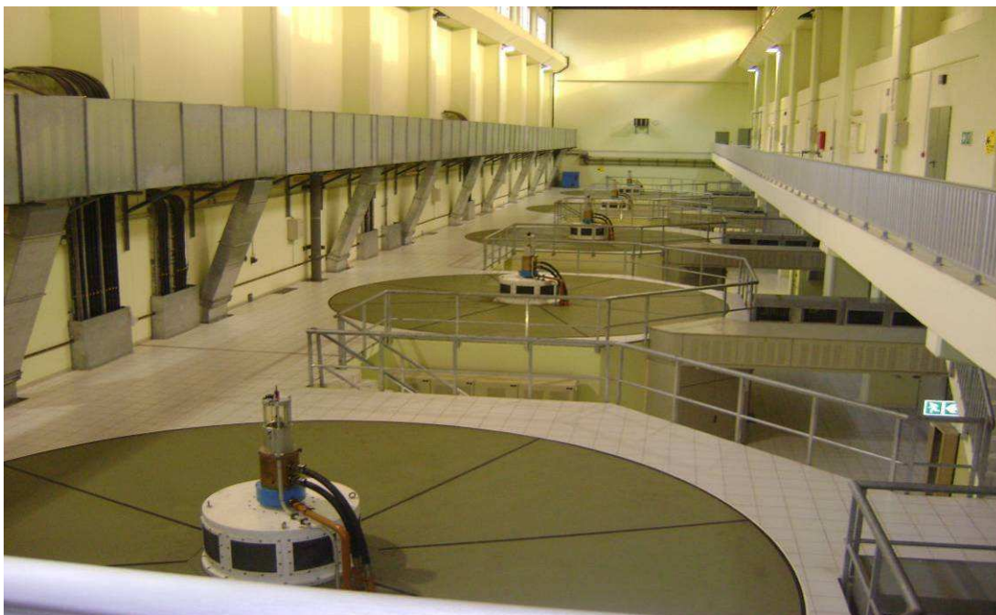
Photo 7 : Centrale de Manantali : salle des machines abritant les cinq turbines de 40 MW
