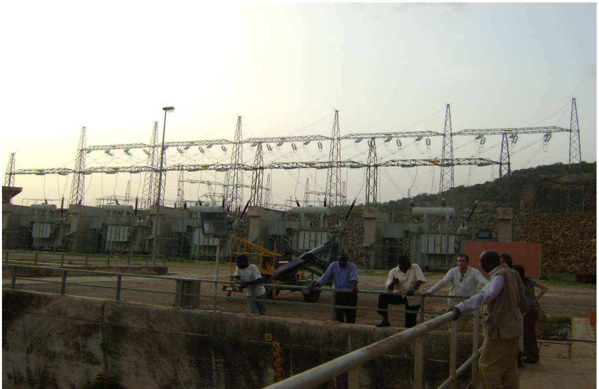
Photo 5 : Les cinq transformateurs qui élèvent la tension à 225 kV au poste de départ de Manantali
